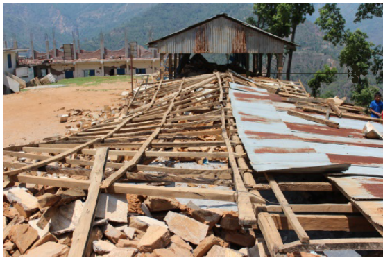
シンドゥパルチョク郡の倒壊した学校
